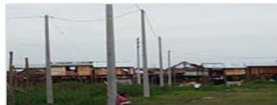
Ampliación de redes de distribución primaria, secundaria, conexiones domiciliarias de los distritos de Iquitos y Punchana III etapa
