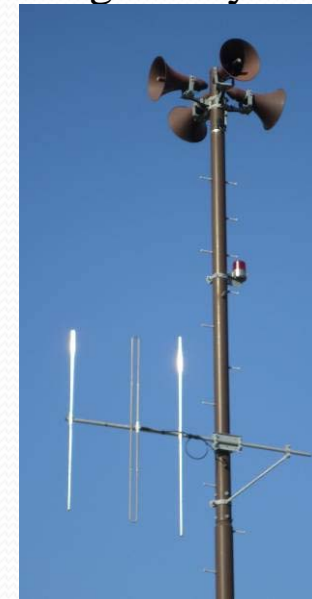
Sistema de transmisión de información sobre Tsunami (sistema de megafonía)
