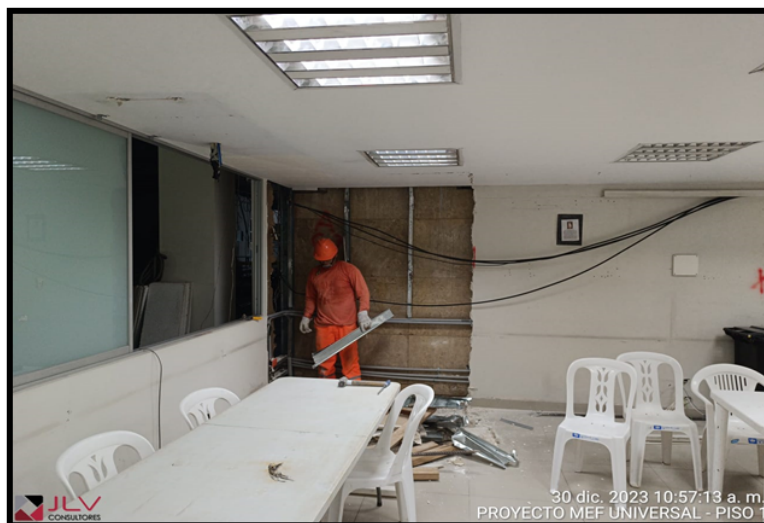
Estado actual de la ejecución de la obra – fotografía al 30 de diciembre del 2023
