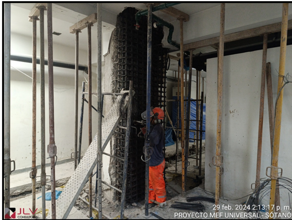
Estado actual de la ejecución de la obra – fotografía al 29 de febrero del 2024
