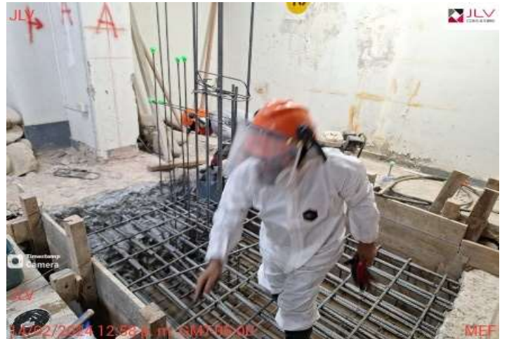
Supervisión verifica el uso de epp para trabajos de aplicación de puente adherente
