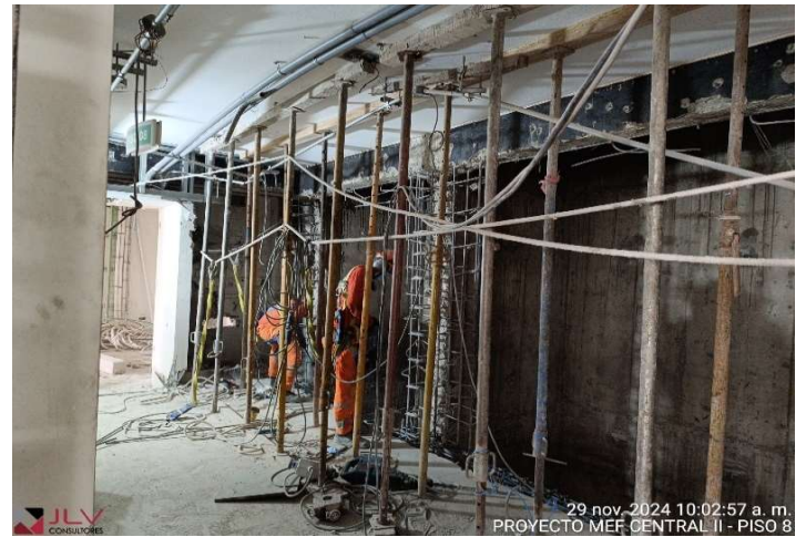
Supervisión constata el avance de la partida de demolición de estructura existente, para el refuerzo en columnas y viga del frontis del ascensor ABC - Central II Piso 8
