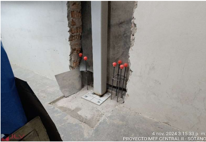
Supervisión verifica la soldadura de la plancha con respecto a la columna metálica - Central II Sótano I
