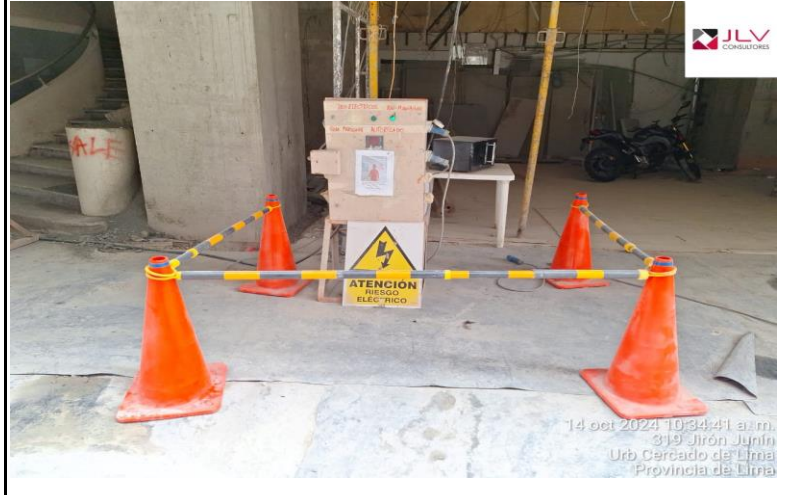
Supervisión verifica que se mantiene señalizado la zona de tableros eléctricos
