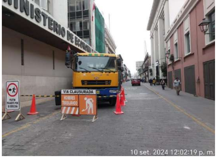
Supervisión verifica la señalización exterior de obra para los trabajos de vaciado
