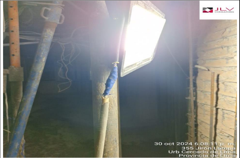
Se realiza la corrección de empalme pero se advierte que debe ser realizada por personal electricista.
