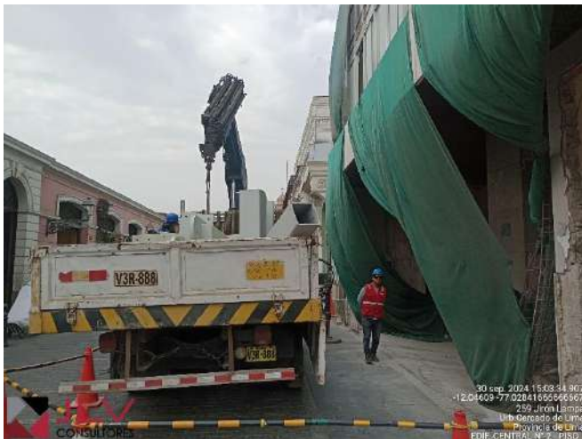
Supervisión evidencia la llegada de la estructura metálica (brazos diagonales) - Exterior de obra.
