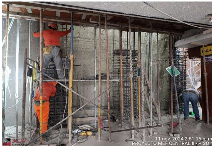
Supervisión constata el avance de la partida de acero de refuerzo en columnas y viga del frontis del ascensor ABC - Central II Piso 4
