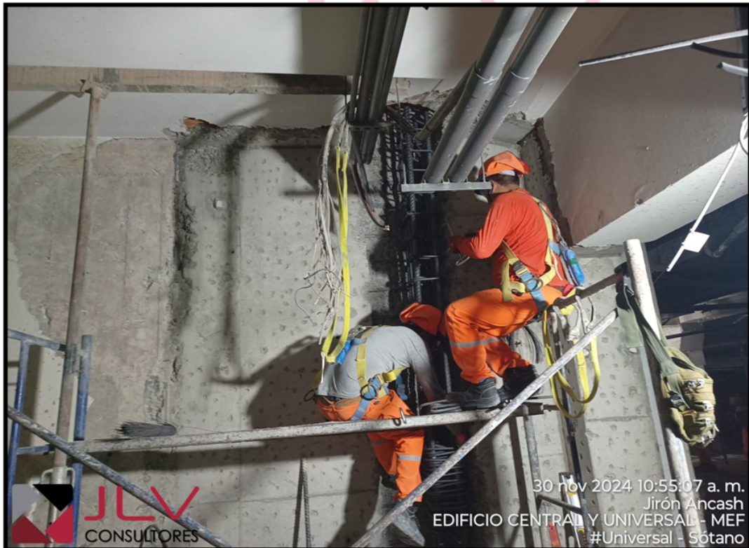
Estado actual de la ejecución de la obra – fotografía al 30 de noviembre del 2024
