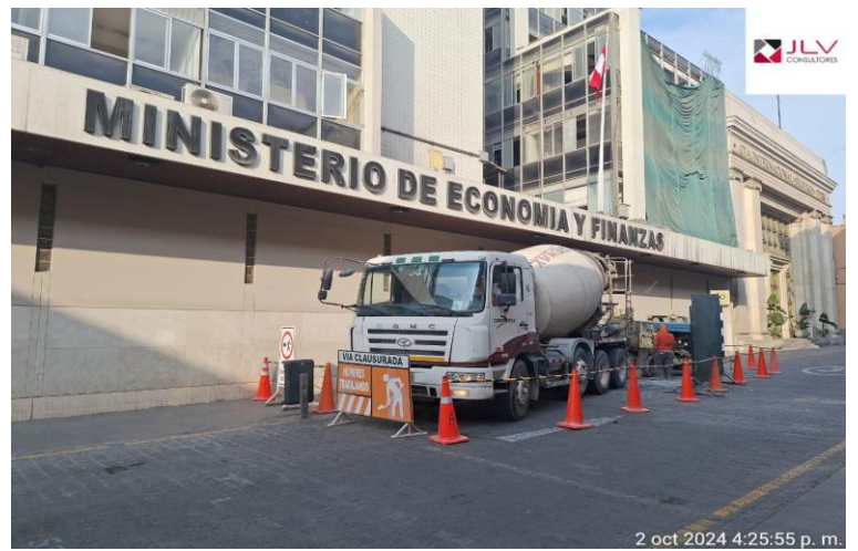
Supervisión verifica la señalización exterior de obra para los trabajos de vaciado de concreto
