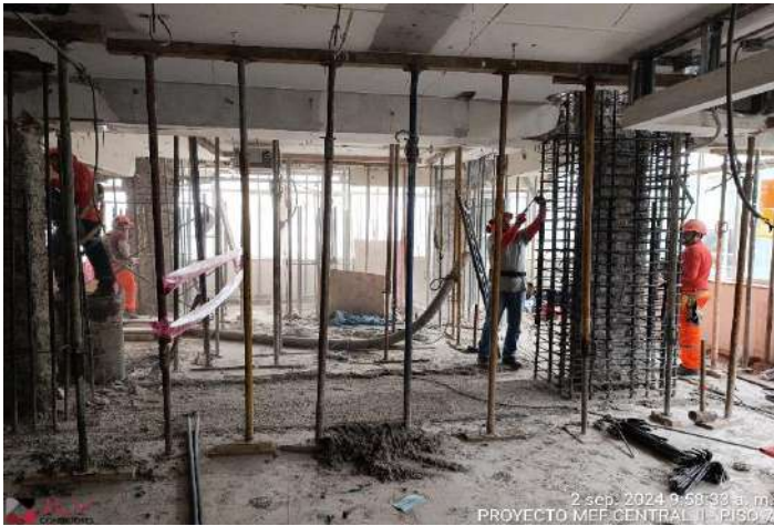
Supervisión evidencia el avance de la partida de acero en las columnas, placas y vigas del piso 7 Central 2.
