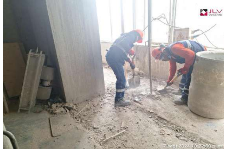
Supervisión verifica la realización de orden y limpieza de las zonas de trabajo
