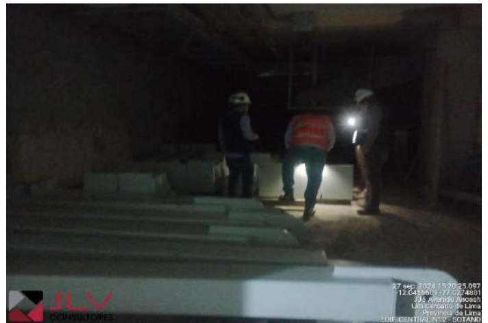
Supervisión inspecciona y verifica las dimensiones de las estructura metálica, almacenadas - sótano universal.
