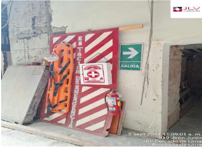
Supervisión verifica el estado de los equipos de contingencia
