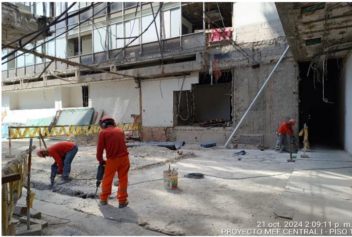
Supervisión observa el avance de la partida de demolición en losa a intervenir, para el reforzamiento de las vigas - Central I Piso 1
