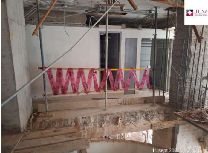
Supervisión verifica la reinstalación de barandas en zona de riesgo de caída
