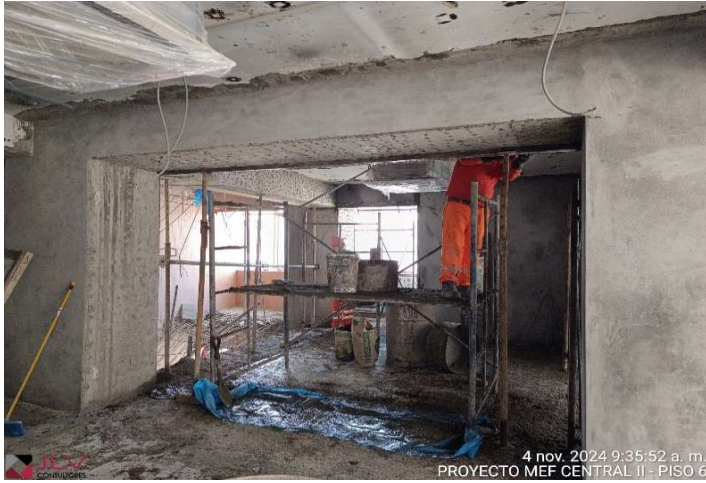
Supervisión evidencia el avance de la partida de tarrajeo en columnas y vigas de estructuras reforzadas - Central II Piso 6
