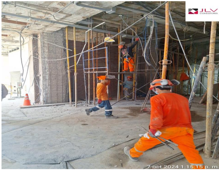
Supervisión advierte sobre personal sobre andamios sin inspeccionar
