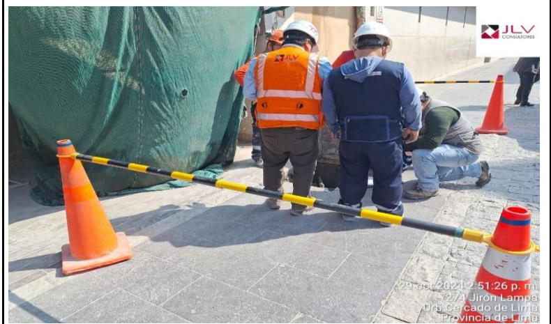
Se realiza el seguimiento del control de medidores de obra y control de fugas
