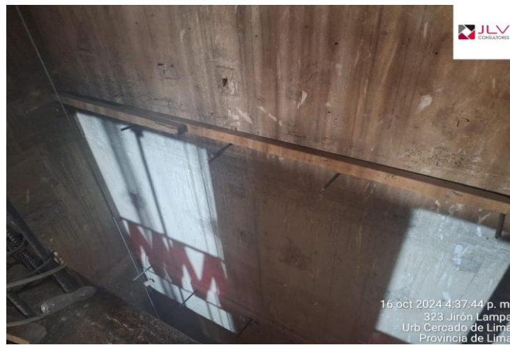
Se realiza el seguimiento a falta de instalación de plataformas de trabajo en la caja de ascensor
