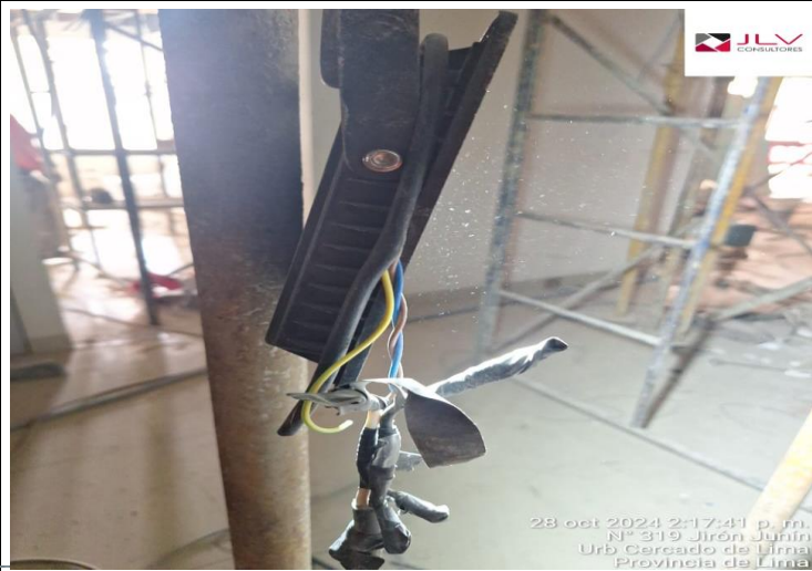
Supervisión advierte sobre conexión eléctrica en mal estado de reflector
