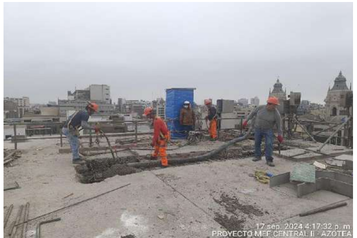
Supervisión verifica el correcto vaciado y vibrado de las vigas - Azotea central 2.
